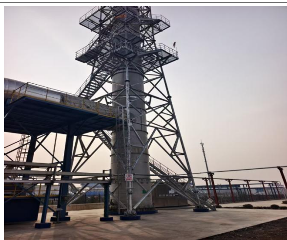
热氧化炉排气筒
